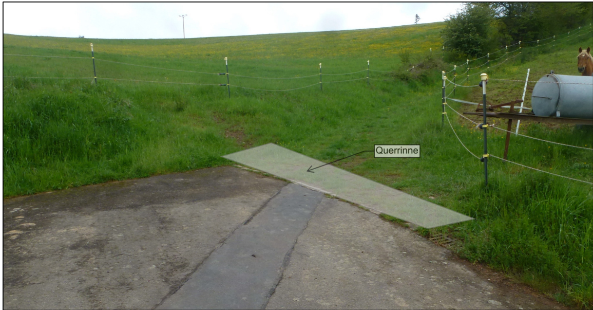
Abbildung 40: zusätzliche Querrinne vor dem Wendehammer
