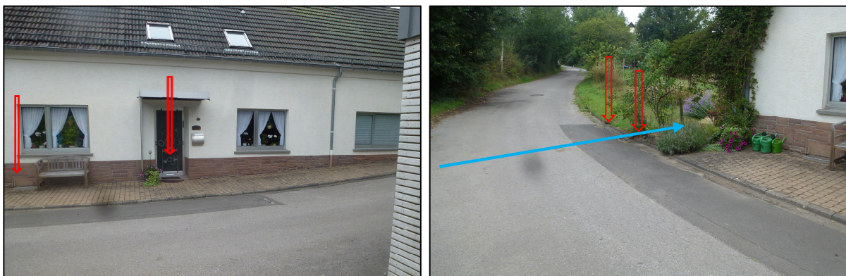
Abbildung 25: Kirchstraße 4, links Ansicht Gebäudeöffnungen, rechts Straßeneinläufe und Abflussweg Neben dem Gebäude gibt es zwei Straßeneinläufe, die einen Teil des Oberflächenwassers aufnehmen können. Im Starkregenfall würde Wasser am Gebäude vorbei in Richtung der
