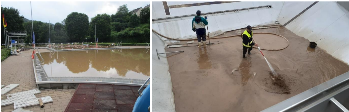
Abbildung 38: beschädigtes Freibad in Waxweiler nach dem Julihochwasser 2021
