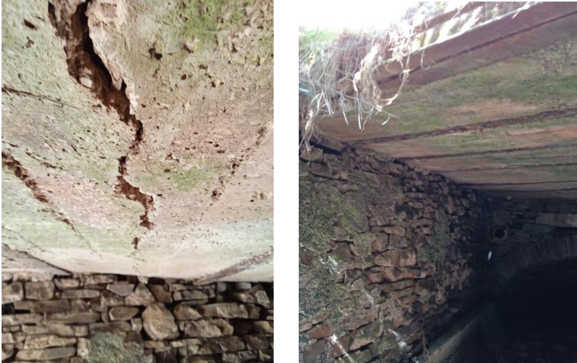
Abbildung 43: Rissbildung in der Decke und Korrosion Stahlträger vom Durchlass im Scheuerweg Direkt hinter diesem Durchlass ist ein großes Stück des in Fließrichtung linken Ufers bis an den Straßenrand abgebrochen und hat einen Schacht freigespült, wie Abbildung 44 zeigt.
