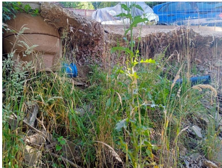
Abbildung 44: abgebrochenes Ufer des Weiherbachs im Scheuerweg
