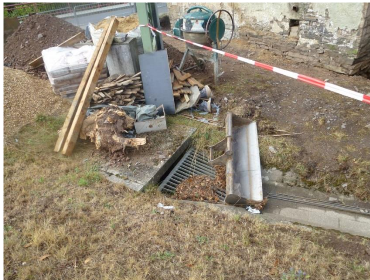
Abbildung 80: Ablagerung von Geräten und Baumaterial am Einlauf der Entwässerung der Luxemburger Straße L 10
