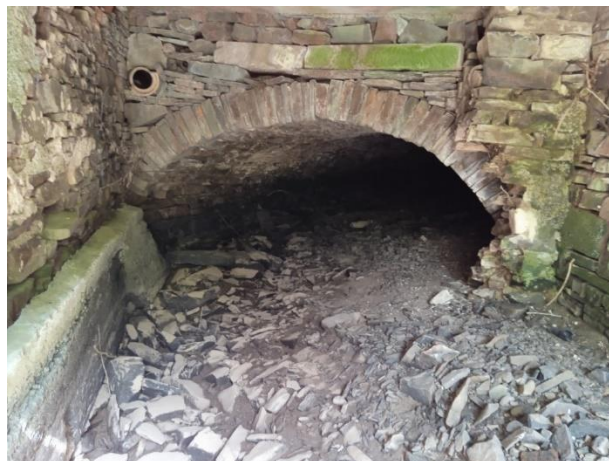
Abbildung 49: Geschiebe im Durchlass Scheuerweg
