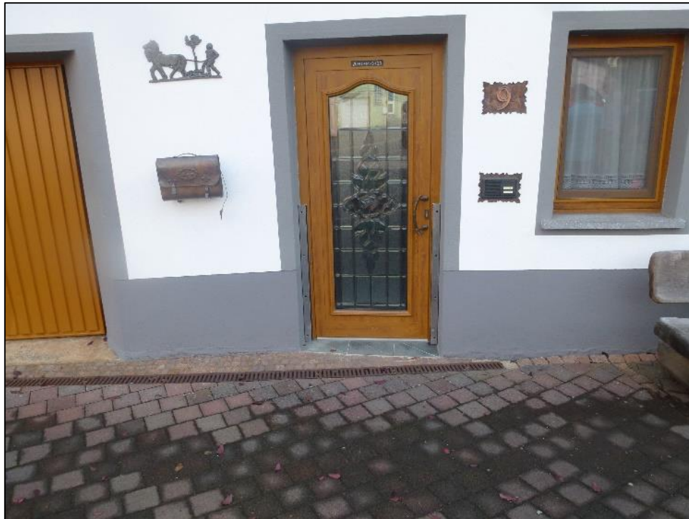
Abbildung 36: Objektschutzmaßnahme am Hauseingang Am Kanal 9 in Waxweiler
