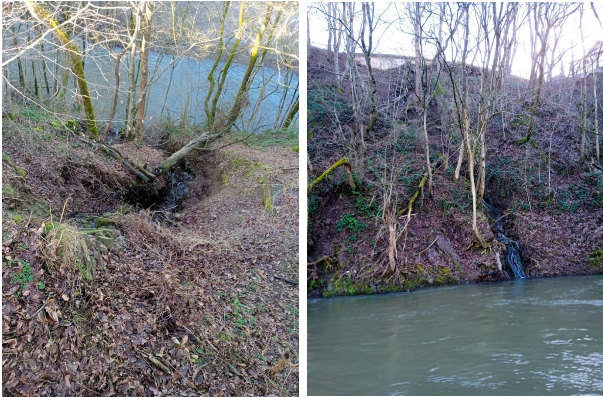
Abbildung 69: Einleitung der Oberflächenentwässerung der Gerhard-Faber-Straße am Kehrberg, links: Ansicht von der Gerhard-Faber Straße, rechts: Blick vom gegenüberliegenden Prümüfer
